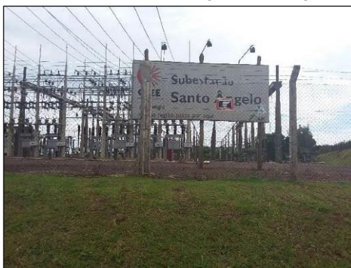
Foto 542. Subestação de energia de Santo Ângelo.
